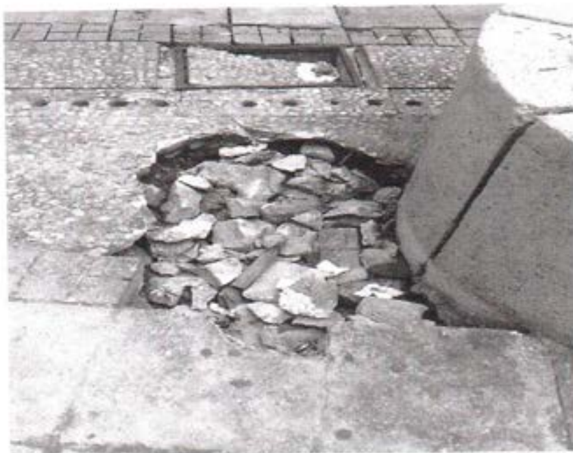
Hueco en la calle Juárez esq. Rafael Martínez de Escobar a la altura de la Fuente Col. Centro.
