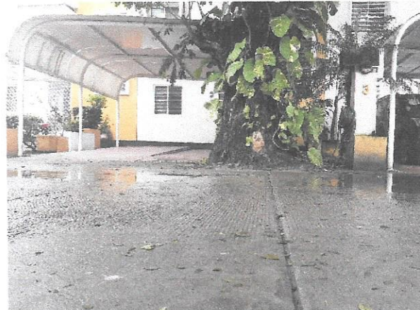
Foto 4. Se logra apreciar el levantamiento de la calle Cedro No. 4 y patio del vecino de la ciudadana promotora.
