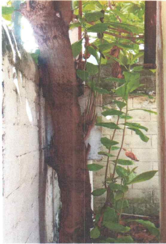
Foto 1. Se observa inclinación de la especie de Almendro sobre la barda perimetral
