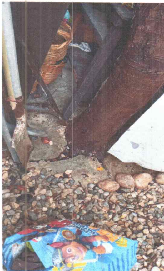
Foto 2. Se logra observar la infraestructura de cimentación levantada a causa de las raíces de la especie de Carambolo.
