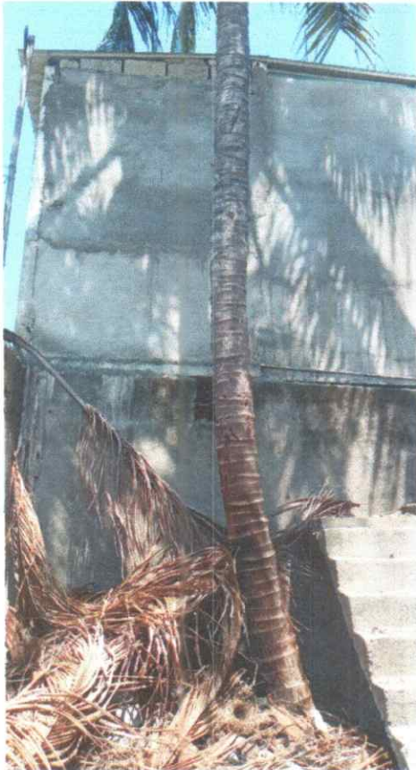
Foto 1. Se observa inclinación de la especie de Palmera de coco hacia la barda perimetral
