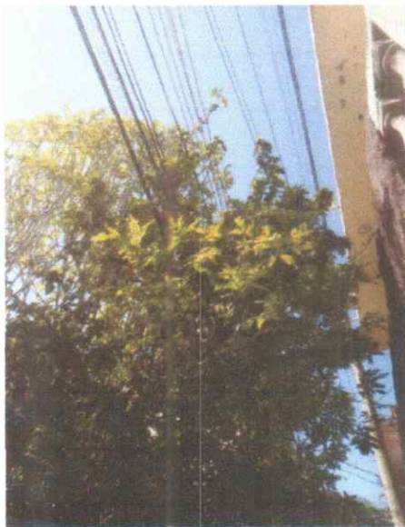
Foto 3. Especies de arbustos obstruyendo el cableado eléctrico.
