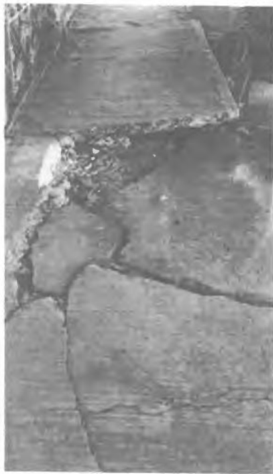
Foto 2. Se logra apreciar daños en la banqueta a causa de las raíces de la especie.
